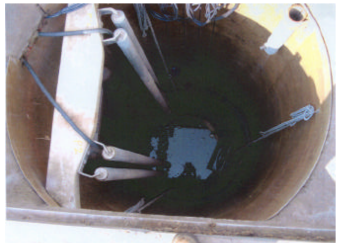
Photo Commune de St Paul : Equipements électriques ruelle des Chocas
